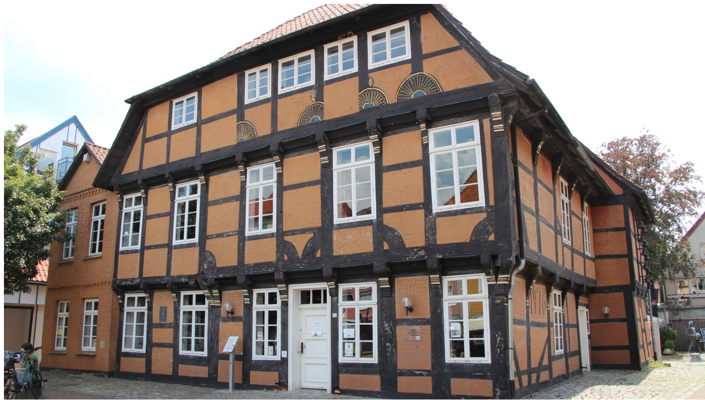
Der Posthof mit der Stadtbibliothek muss dringend saniert werden.
